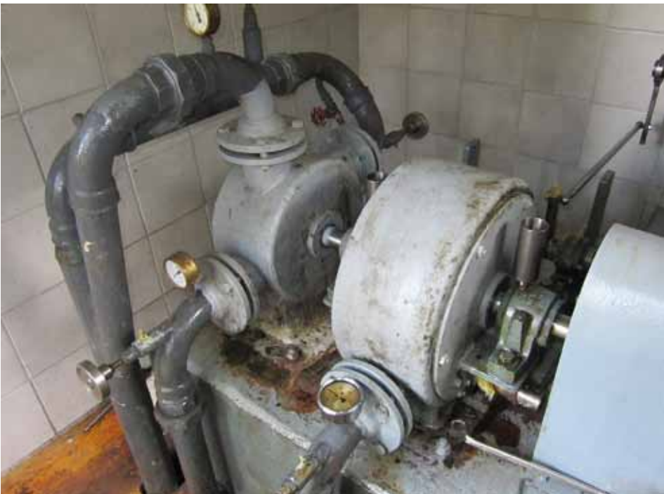
Abb. 1: Die alte Anlage
