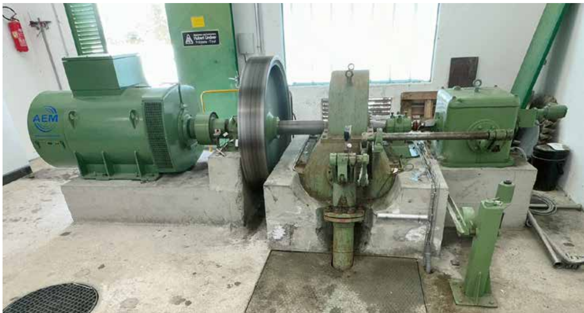
Pelton-Turbine des Wasserkraftwerkes auf der Eng Alm
