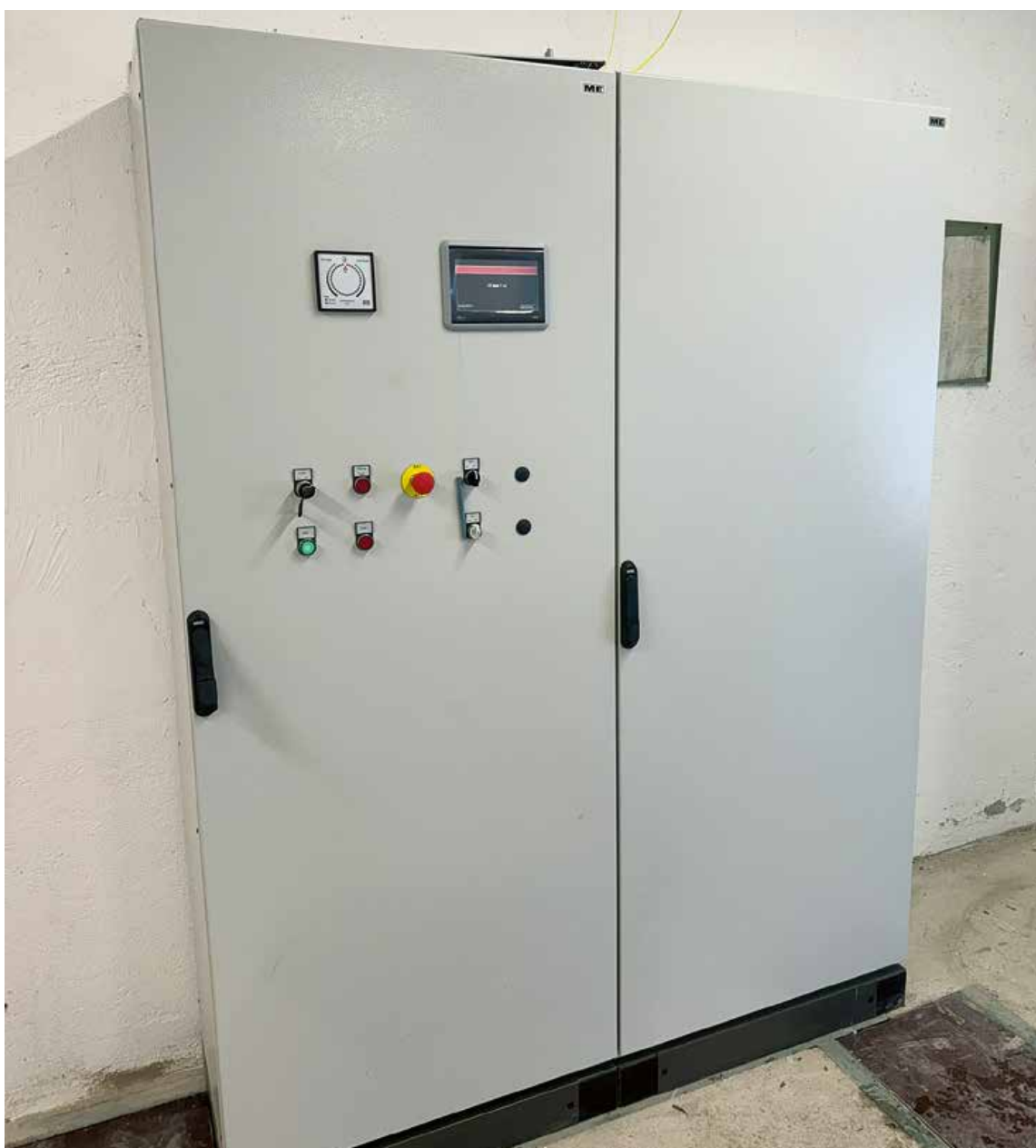
Die neue Schaltanlage ist mit modernsten Überwachungs- und Visualisierungssystemen ausgestattet.
