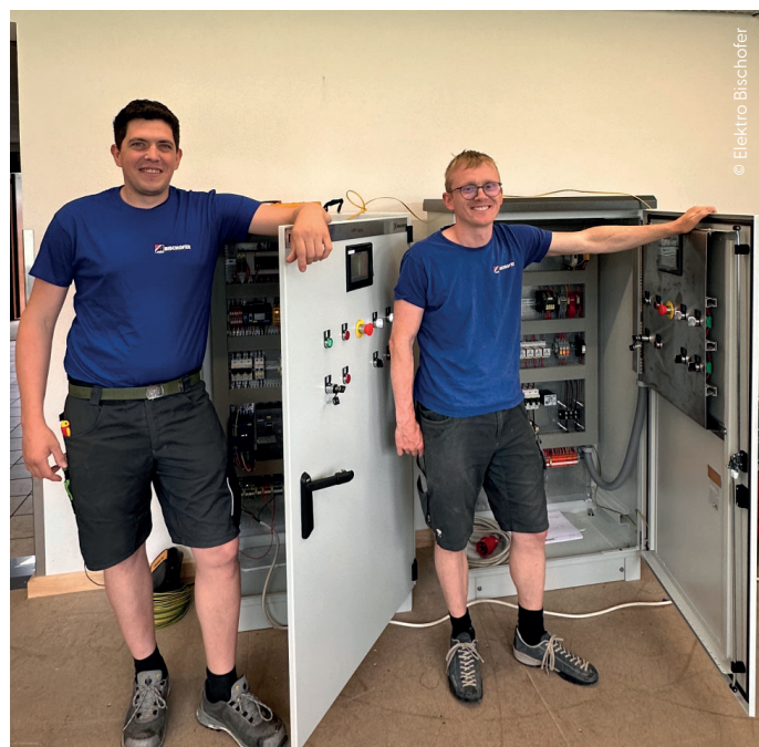
Die beiden Elektro Bischofer Mitarbeiter Daniel und Philipp bei der Endkontrolle zweier Schaltanlagen. Elektro Bischofer hat seine Wurzeln in der Elektro- und Steuerungstechnik.
