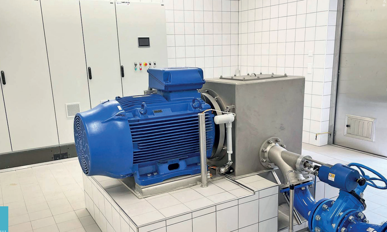
Elektro Bischofer rüstet Trinkwasserkraftwerke aus einer Hand aus. Im Bild: das TWKW Ullach im Salzburger Leogang – erfolgreich realisiert 2022.
