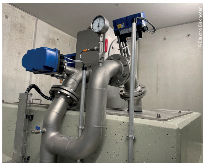
Die Trinkwasserkraftwerke sind in der Regel mit einem Bypass-System ausgerüstet, damit bei einem eventuellen Turbinenstillstand die Trinkwasserversorgung aufrecht erhalten werden kann. Sämtliche Teile, die mit Wasser in Berührung kommen, sind in Edelstahl ausgeführt.
