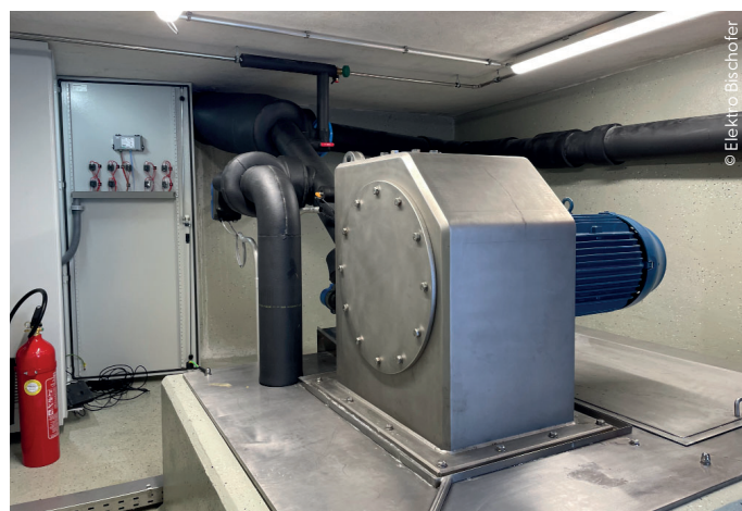
2024 ging das Trinkwasserkraftwerk Bärfeld in Fieberbrunn in Betrieb.
