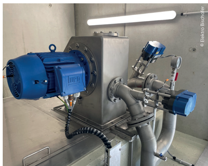
Trinkwasserkraftwerk Waldhof in Kirchberg in Tirol: Ausbauleistung: 8,5 kW Fallhöhe: 140 m Ausbauwassermenge: 8 l/s Turbine: 1-düsige Pelton-turbine Inbetriebnahmen: 2025 Betrieb: Netzparallelbetrieb
